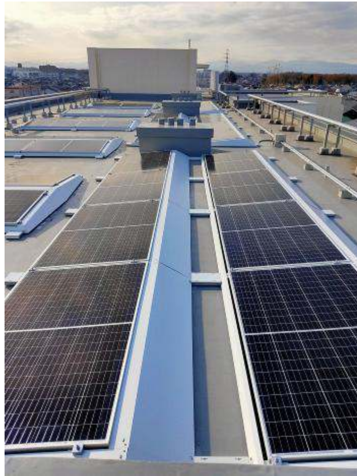
向陽中学校屋上の太陽光発電設備
